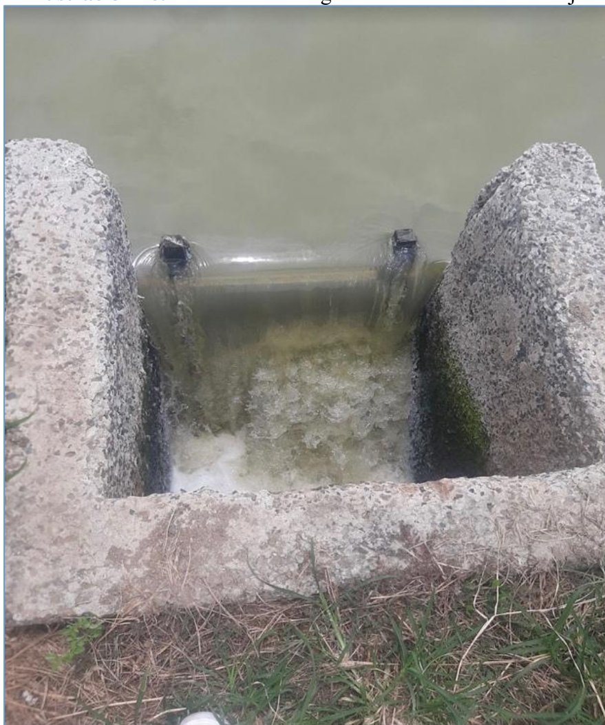
Ilustración 46. Tratamiento de agua residual PTAR Portoviejo
