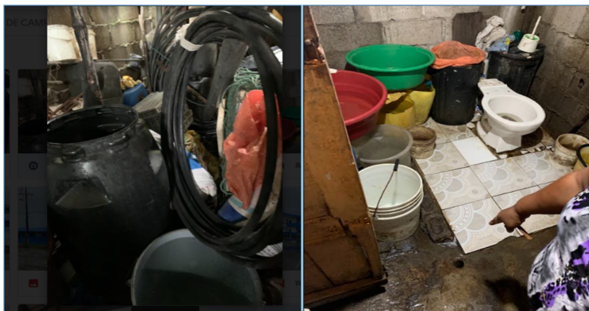
Ilustración 26. Instalaciones sanitarias en hogar del barrio América
