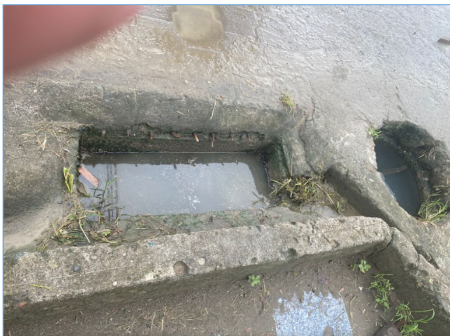
Ilustración 15. Alcantarillado colapsado en calles de la cabecera cantonal de Muisne
