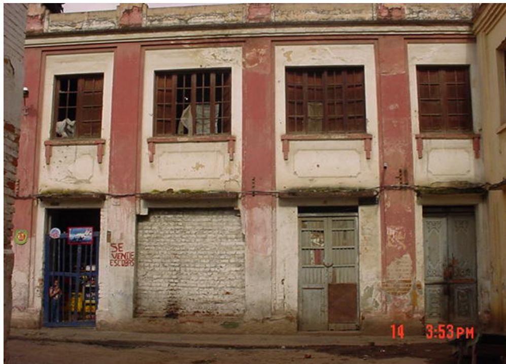
Foto 3. Deterioro físico patrimonio arquitectónico
